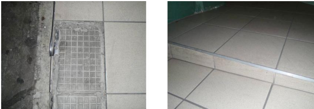
Figura 39. Fallos en la instalación y en el mantenimiento, Jhb, (colección de la autora).
