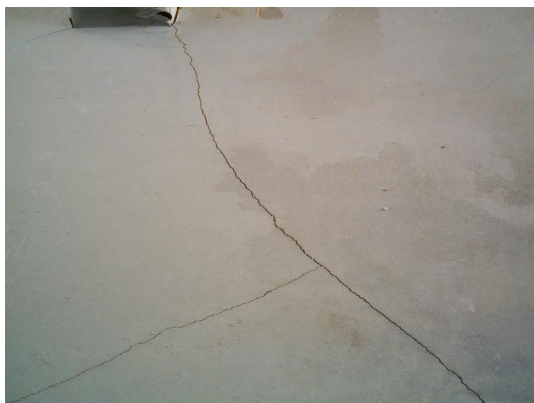
Figura 5. Fisuración. Ancho de fisura >3mm.
