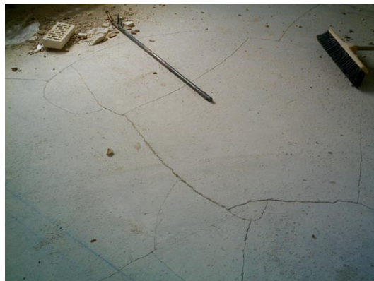
Figura 6. Fisuras en "tela de araña".
