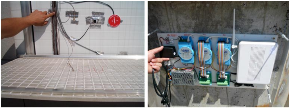
a) Sensores instalados.
