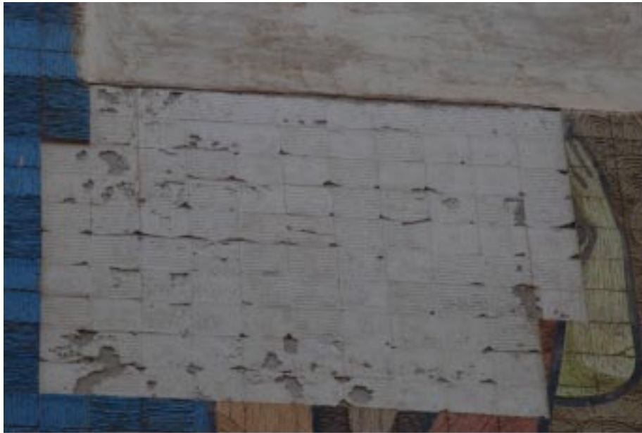
Figura 16. Estado de la superficie del mural previo a la restauración.
