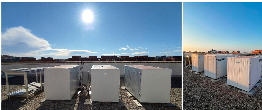
Ilustración 4. Prototipos operativos en la cubierta del ITC
