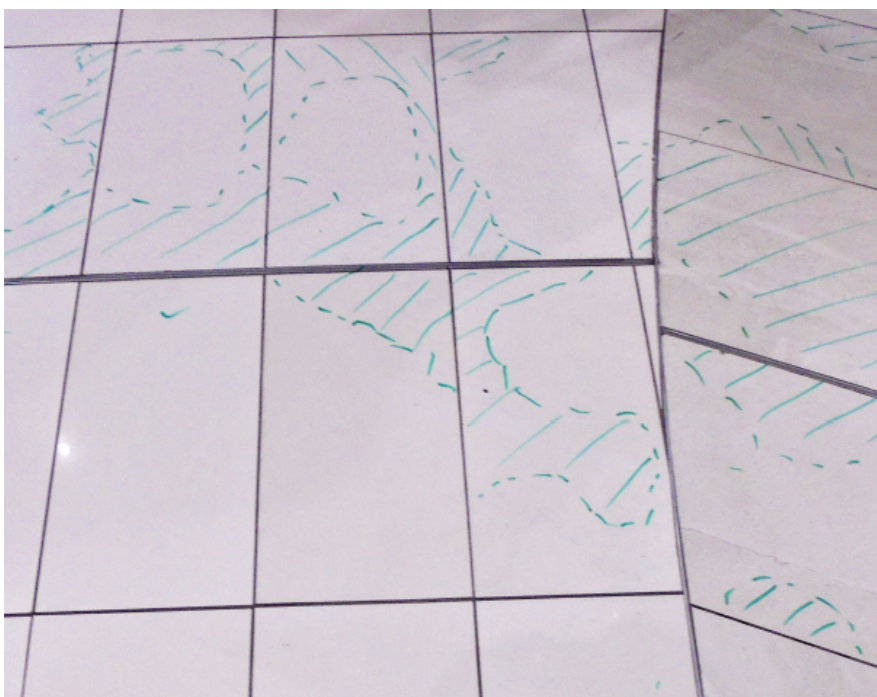
Figura 3. La repetición de los detalles claves señalados por parte de un técnico diferente, aproximadamente un año después, tomada sin referencia a la primera foto, encontró una zona algo mayor de baldosas huecas. Esto podría indicar que la zona de sonido hueco se expandía o simplemente se debía a la distinta percepción del nuevo inspector o al equipo utilizado. De cualquier manera, la evaluación de las zonas de sonido hueco ha sido más válida y fiable porque ha podido repetirse. Esto es bueno, pero no perfecto.
